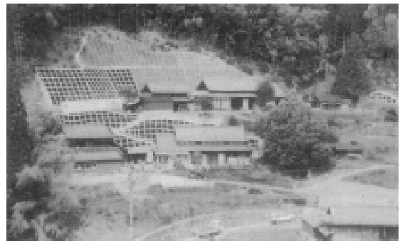
自然災害防止急傾斜地崩壊対策事業 (西郷村 上小八重地区)
