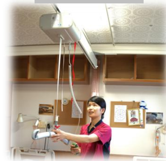
天井走行リフト
