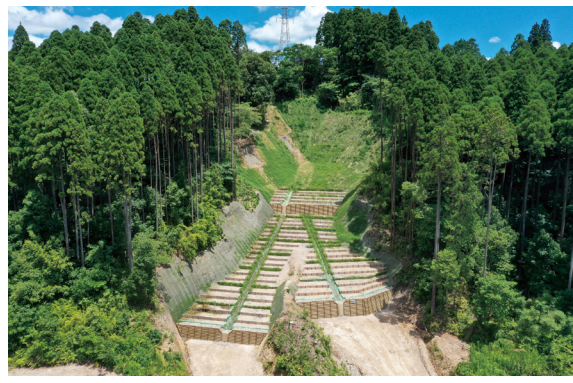
治山施設(木製校倉式土留)
