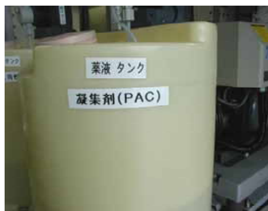
凝集剤溶液タンク 2002/7/27
