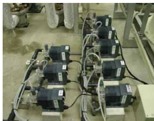
塩素注入ポンプ 2002/7/27
