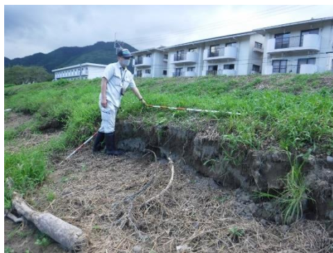
R05災 河川災害復旧工事（広渡川） 被災状況（護岸決壊）
