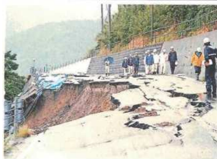
地滑りで崩落した国道448号の路面を見て回る国土交通省、串間土木事務所の職員ら 二17日午後3時、串間市大納・小崎地区
