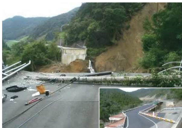
写真4.1.18 橋梁被災状況 (日南市:五塚橋)
