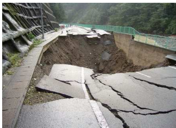
写真4.1.4 国道265号の被災状況 (椎葉村:耳川)
