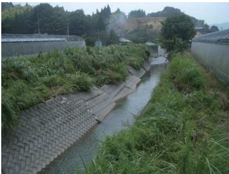
写真4.3.6 潟上川被災状況
