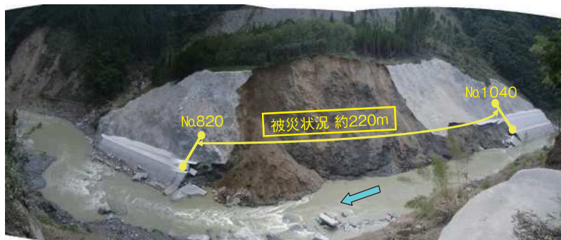
写真4.3.8 耳川被災状況
