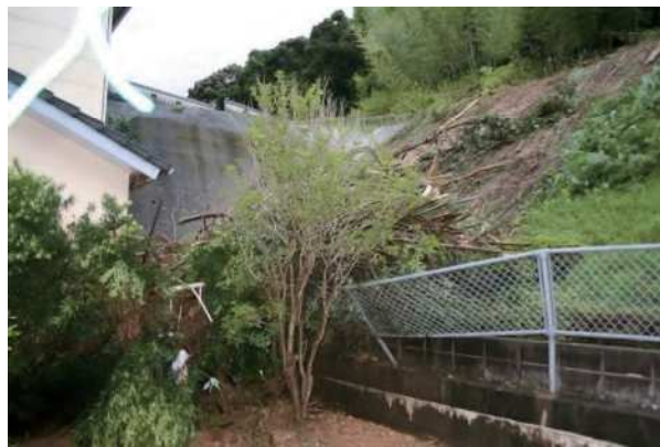
写真4.3.4 竹の上地区被災状況
