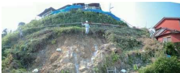
写真4.3.1 八幡地区被災状況
