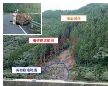
写真4.7.1 8月の被災状況
