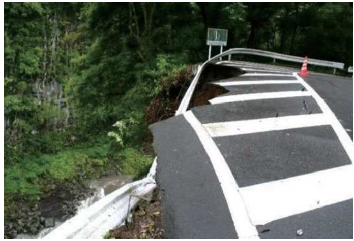
写真4.6.2 町道下押方片内線崩壊状況 (出典:高千穂町HP)
