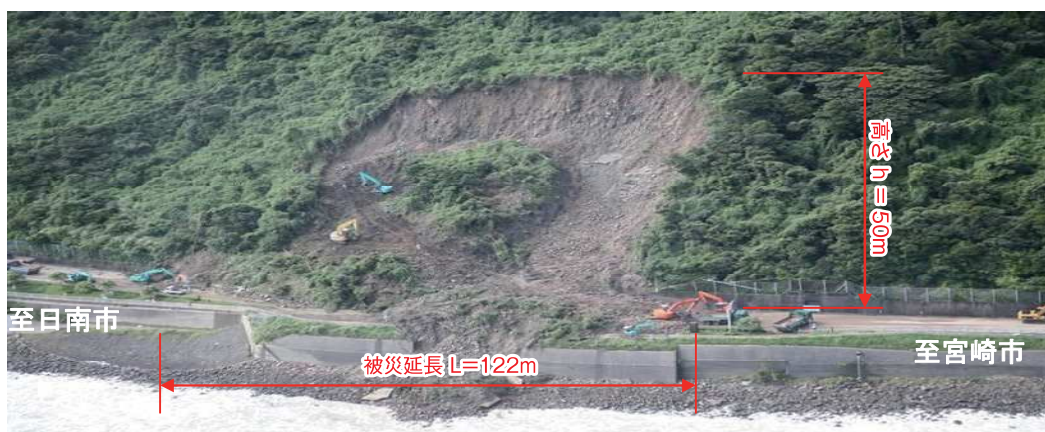
写真4.4.1 国道220号被災状況 (1)
