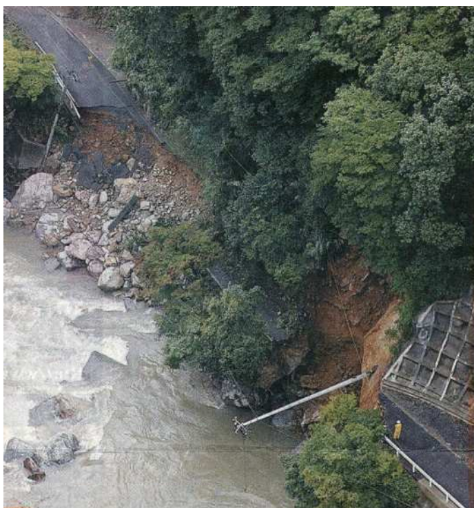
写真4.3.10 県道日之影宇目線決壊状況
