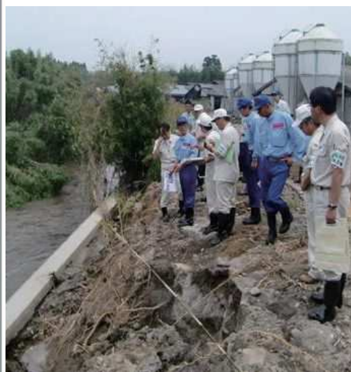
写真4.5.16 災害査定状況
