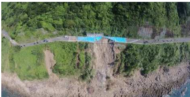
写真 4.9.1 被災直後（上空から）
