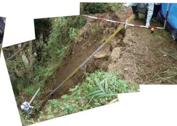
写真4.10.8 吉野第2地区被災状況
