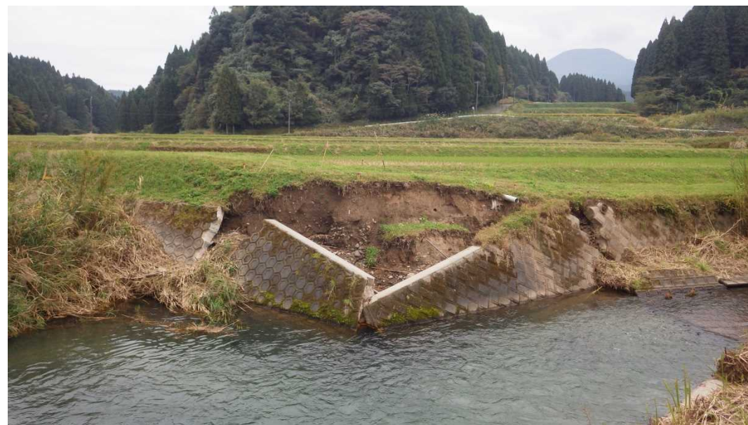
出水川 被災状況
