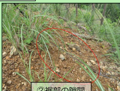
②裾部の隙間
