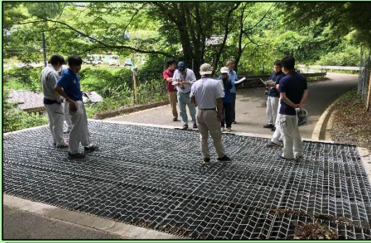
五ヶ瀬町で導入した「グレーチング」
