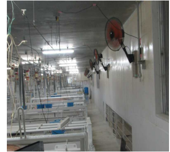
写真1 壁掛扇風機6台
