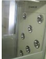
クリーンルーム内 エアシャワー
