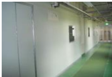
クリーンルームパネル設置例
