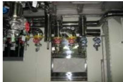
GMP空調(封じ込め)設置例
