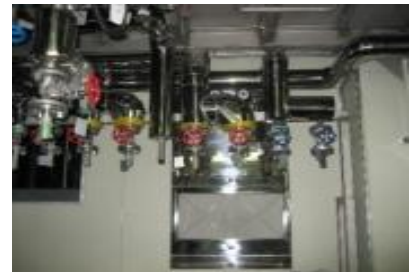
GMP空調(封じ込め)設置例
