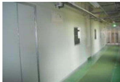
クリーンルームパネル設置例
