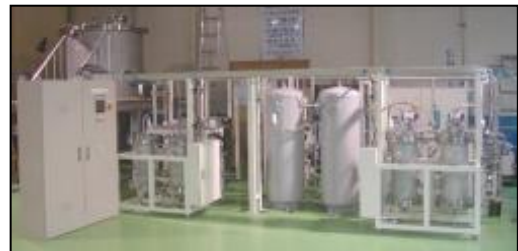
排水処理装置
