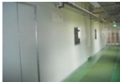
クリーンルームパネル設置例
