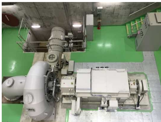
酒谷発電所水車発電機
