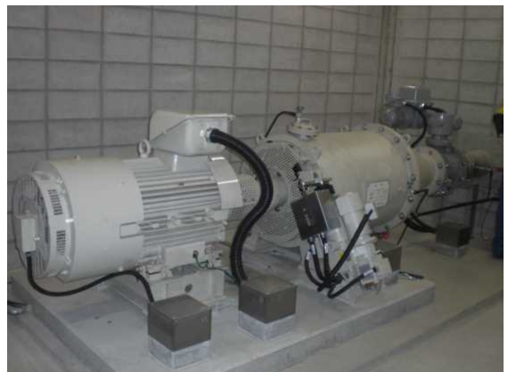
祝子第二発電所水車発電機
