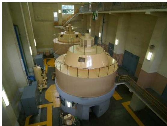
綾第二発電所発電機
