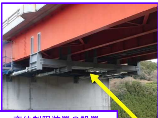
変位制限装置の設置 地震時の免震効果を発揮
