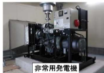
非常用発電機
