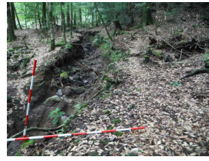
洗掘された歩道
