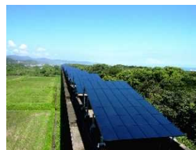
太陽光発電所
