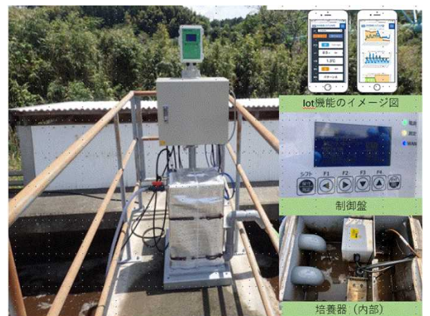
【養豚排水処理のスマート新技術 (BOD監視システム)】
