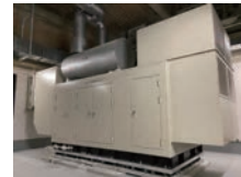
非常用発電機
