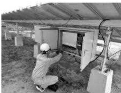
太陽光発電設備維持管理の課題 ・常時監視 ・不具合検出機能の追加
