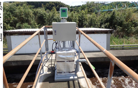
浄化槽BOD監視システム
