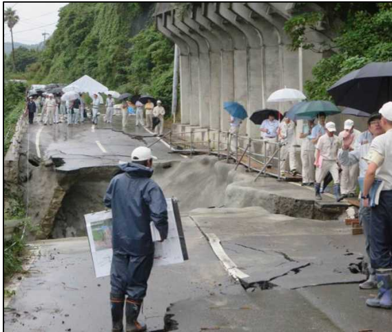
大雨により崩壊した道路の復旧
