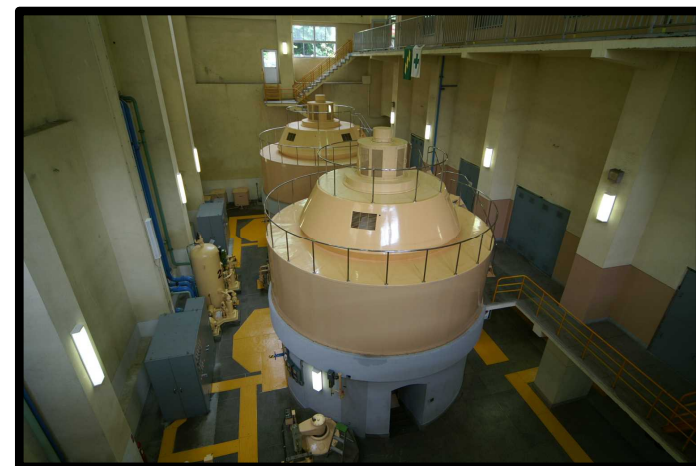
綾第二発電所発電機
