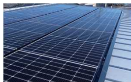
住宅屋根の太陽光パネル
