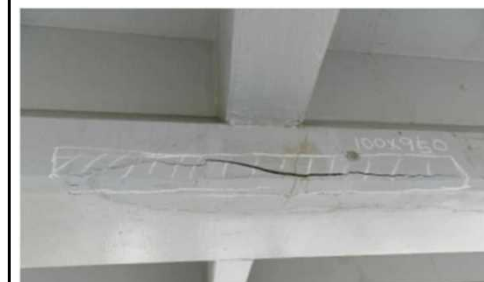
橋梁の老朽化対策（ひび割れ）
