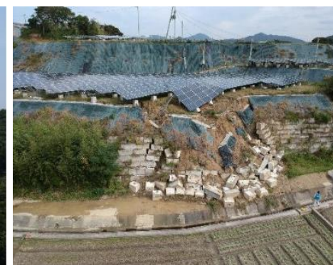
法面保護工が崩れて流出した事例
