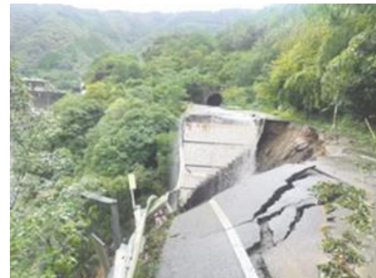
令和4年台風第14号による被害
