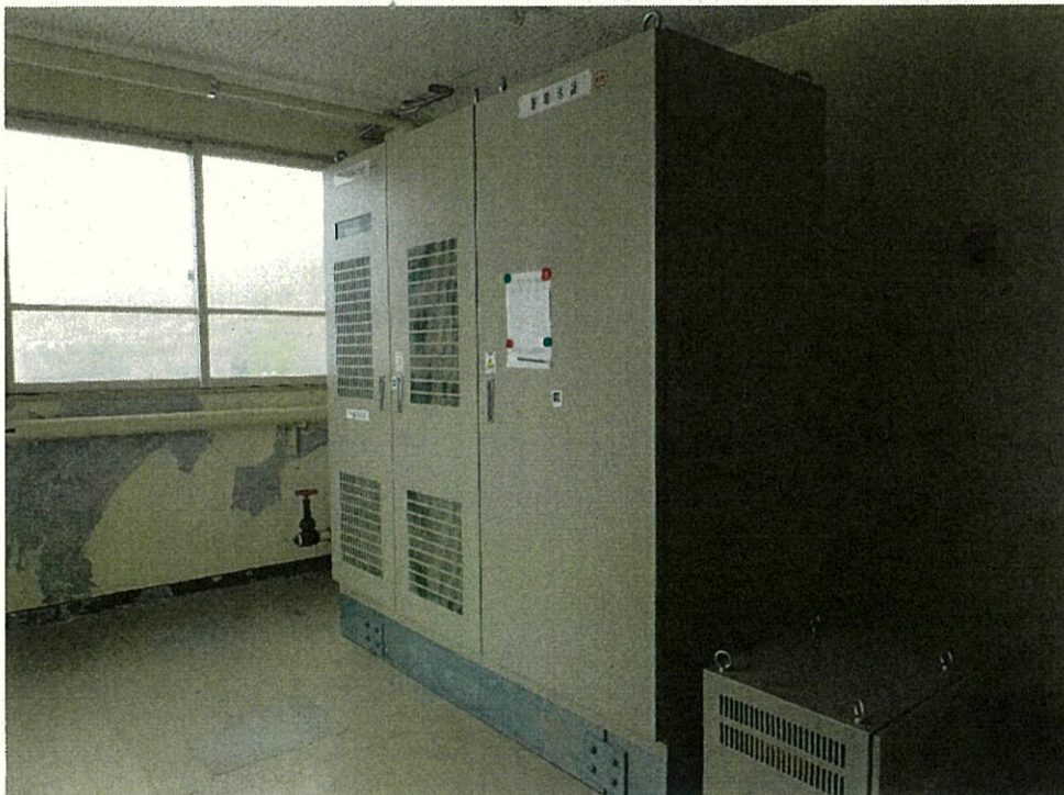
○太陽光蓄電池
