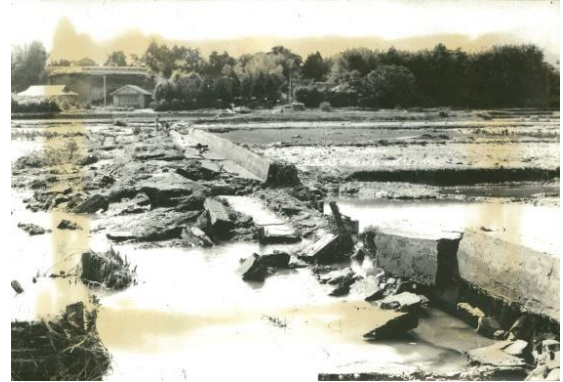
水路破壊により水田が流出 (南那珂郡福島町)
