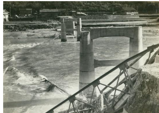
流失した鉄橋 (延岡市北方町)
