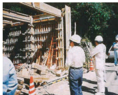
建設中の現場を立ち入り検査する公開建築パトロール
