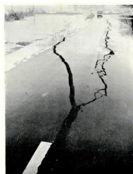
【資料4】地割れした国道268号線（『えびの地震の記録』より）
