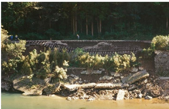
早日渡～亀ヶ崎間（現延岡市北方町）築堤崩壊 (36940「平成2年～平成5年 高千穂鉄道（株）鉄道災害復旧」)
