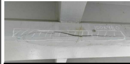
橋梁の老朽化対策(ひび割れ)
