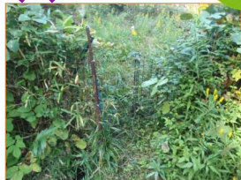
柵の開閉部が破損
