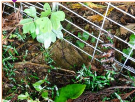
柵の下部に隙間あり
