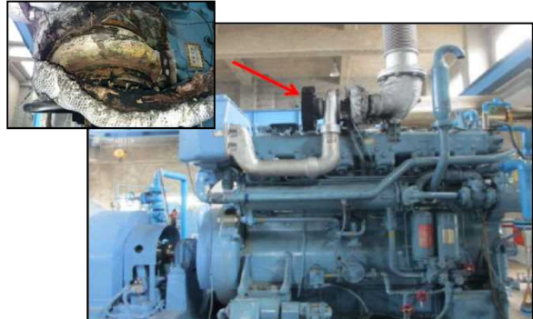
排水機場 原動機エンジンの加吸器焼き付け
