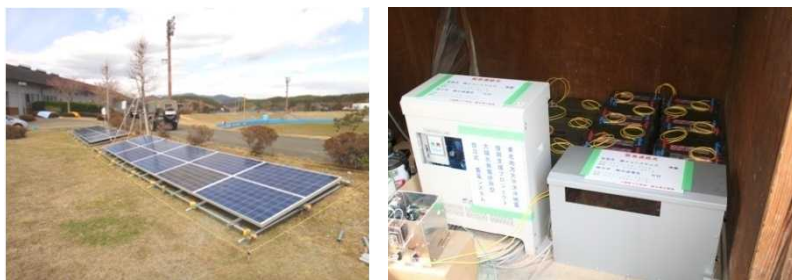
避難所に太陽電池を用いた蓄電システムを設置
